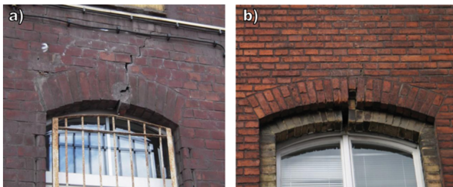
Fot. 1. Przykłady uszkodzeń nadproży łukowych
